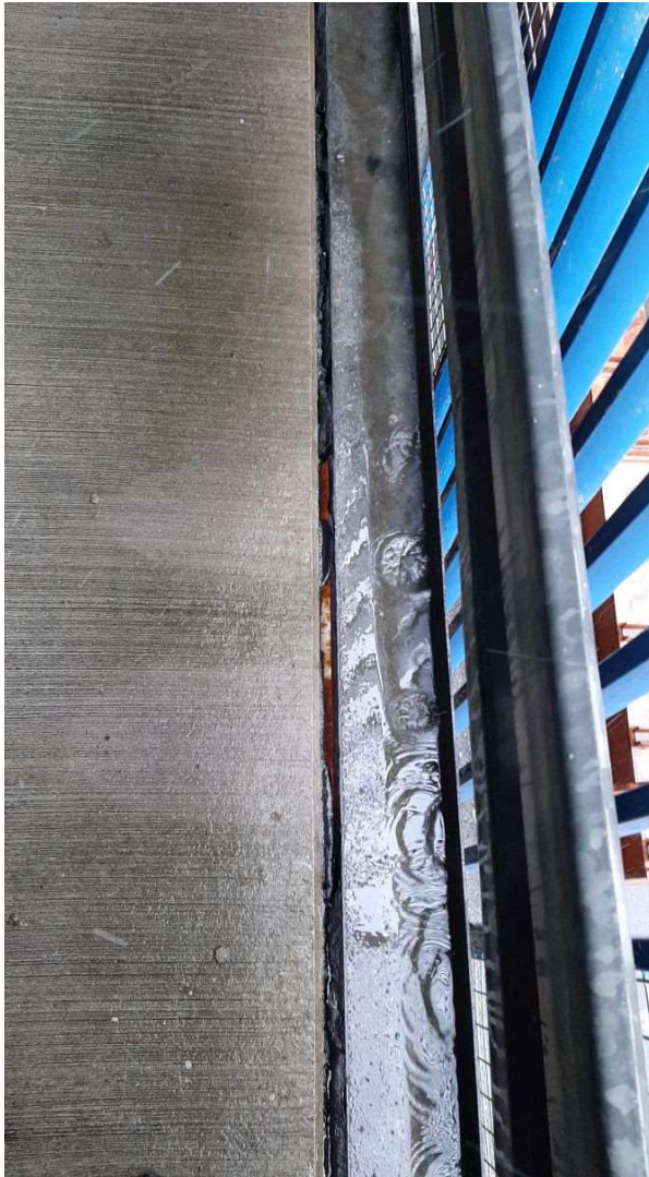
Bild 121 Allgemeine Schäden (B2713)
