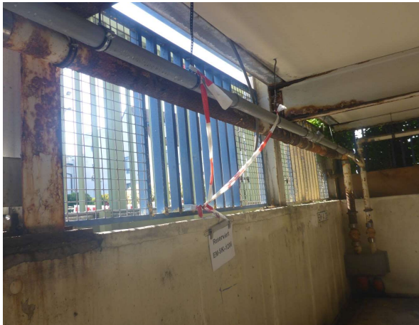
Bild 127 Allgemeine Schäden (B0266)
