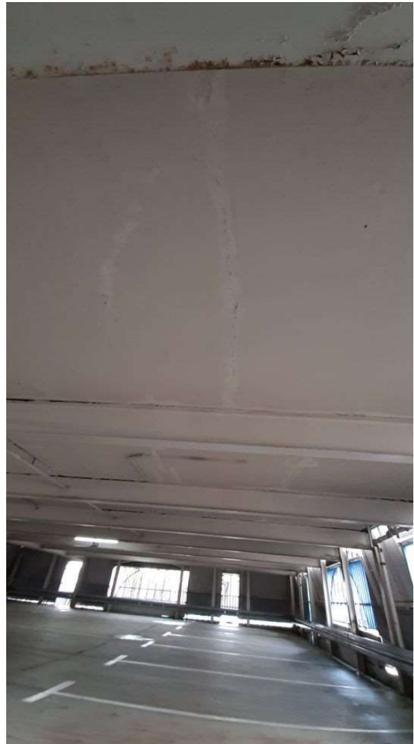
Bild 124 Allgemeine Schäden (B3645)
