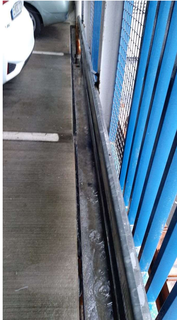
Bild 122 Allgemeine Schäden (B2716)
