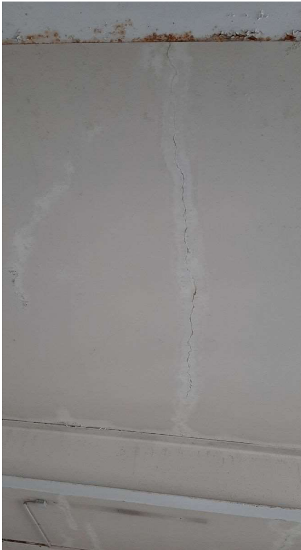
Bild 123 Allgemeine Schäden (B3635)
