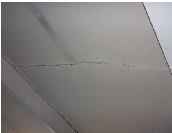
Bild 125 Allgemeine Schäden (B0089)
