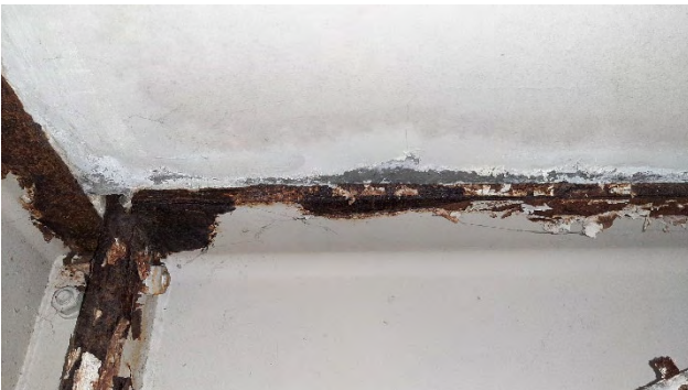
Abbildung 44: korrodiertes Stahlträger unter gerissener Querfuge
