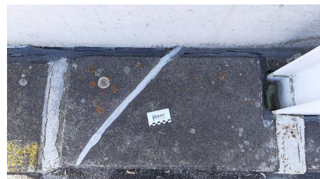
Abbildung 11: nicht funktionsfähige Fugenverfüllung im Bereich der Treppenhauswand
