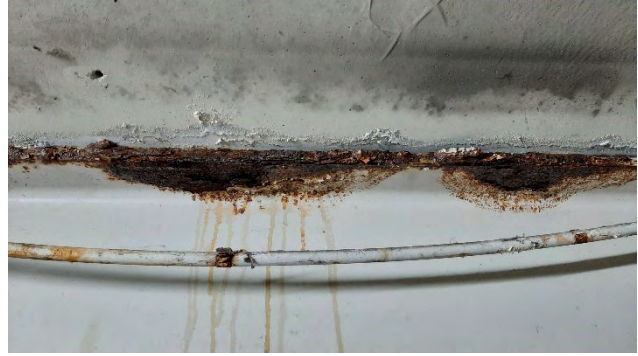
Abbildung 43: korrodiertes Stahlträger am seitlichen Auflager
