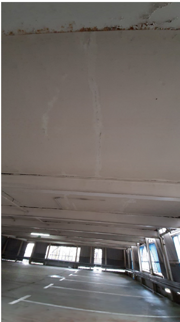
Abbildung 24: Risse mit deutlichen Feuchtespuren
