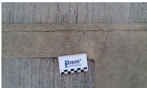
Abbildung 29: Riss in Längsfuge
