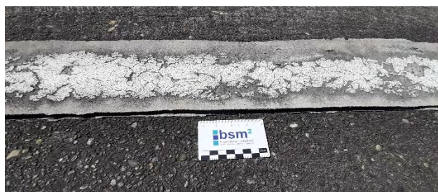
Abbildung 5: abgelöste und gerissen Fugenabdeckung
