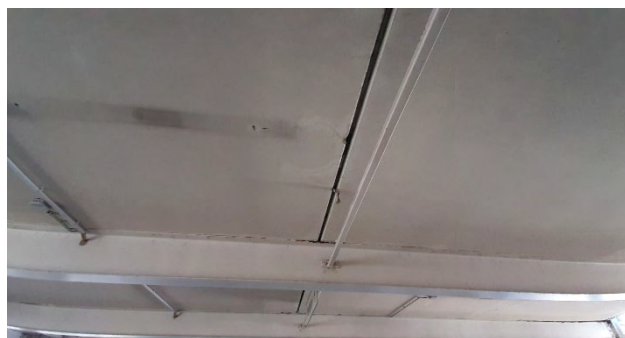
Abbildung 27: Risse mit deutlichen Feuchtespuren
