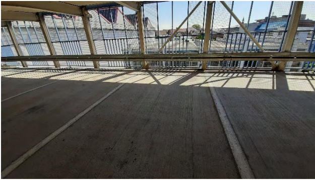
Abbildung 30: Risse in Querfuge
