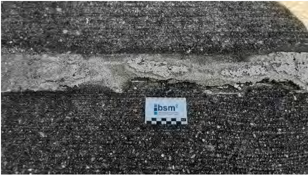
Abbildung 36: Abgelöste und verwitterte Fugenabdeckung
