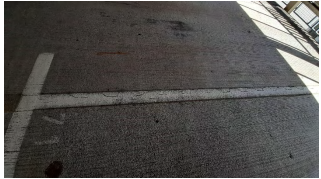
Abbildung 31: Risse in Querfuge (Konstruktion der Plattenränder erkennbar)
