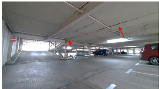
Abbildung 41: Bereiche mit Korrosion unter den Längsfugen und im Auflagerbereich
