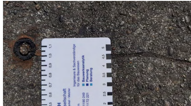
Abbildung 7: behandelter Riss, Bohrpacker in Riss gesetzt, verfüllte Rissbreite
