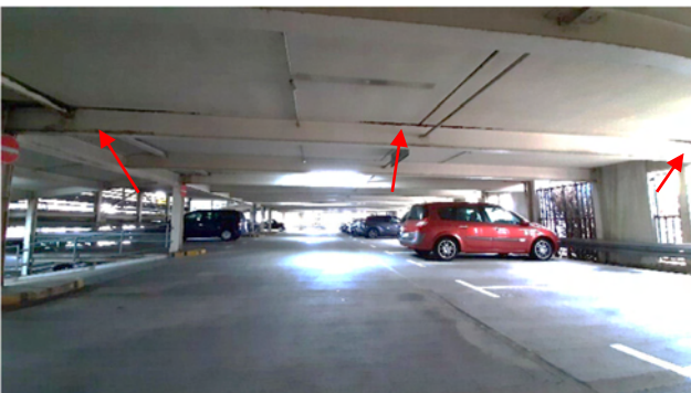
Abbildung 40: Bereiche mit Korrosion unter den Längsfugen und im Auflagerbereich
