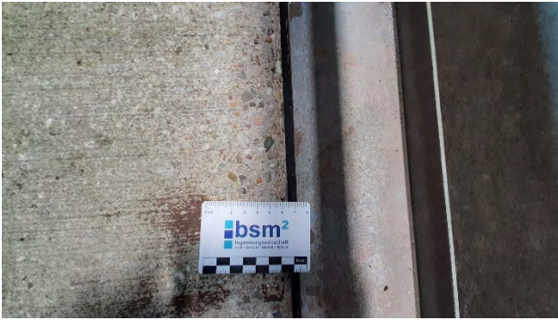
Abbildung 18: offene Fuge zwischen Entwässerungsrinne und Bauteilkante
