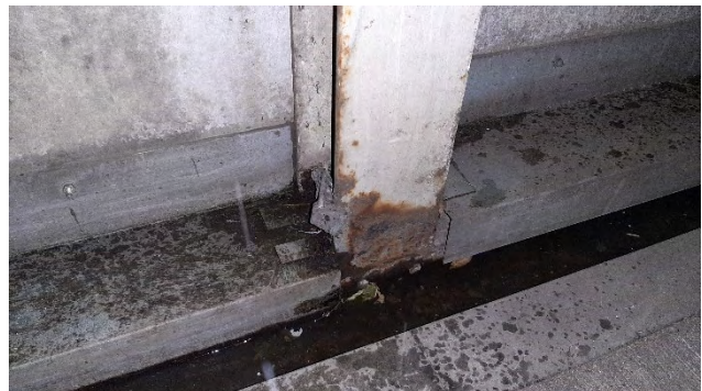
Abbildung 47: korrodiertes Fußbereich einer Stahlstütze
