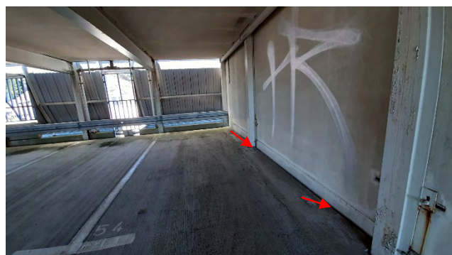
Abbildung 17: defekte und/oder nicht vorhandene Fugenverfüllung (aufgehende Bauteile)
