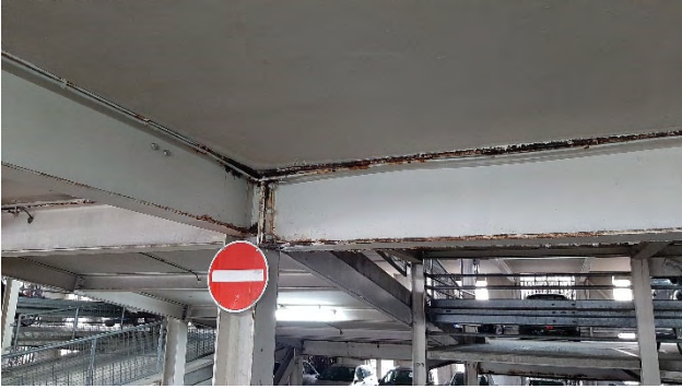
Abbildung 42: korrodiertes Stahlträger unter gerissener Längsfuge
