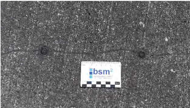
Abbildung 6: behandelter Riss, Bohrpacker in Riss gesetzt
