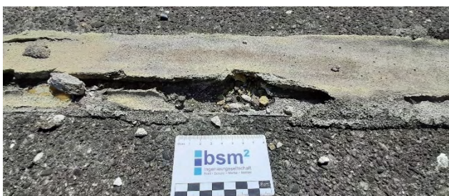
Abbildung 4: abgelöste und gerissen Fugenabdeckung
