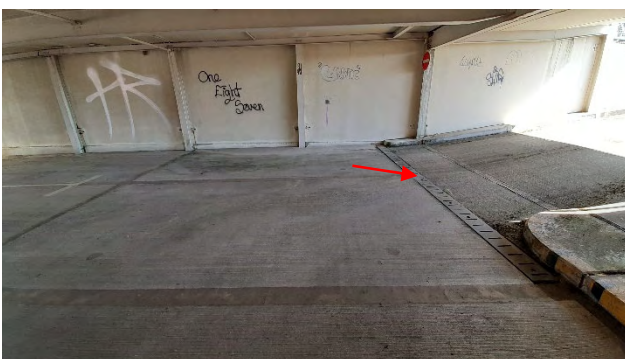
Abbildung 16: Entwässerungsrinne am Rampenfußpunkt
