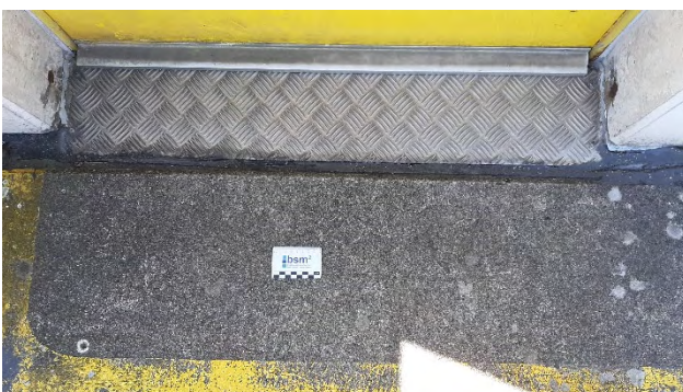
Abbildung 10: nicht funktionsfähige Fugenverfüllung im Eingangsbereich Treppenhaus
