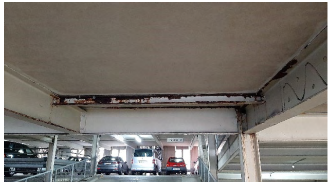
Abbildung 45: korrodiertes Stahlträger im Fußpunkt einer Rampe
