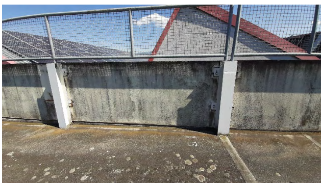
Abbildung 2: verwitterte Oberfläche, kein erkennbarer Anstrich (Attika)
