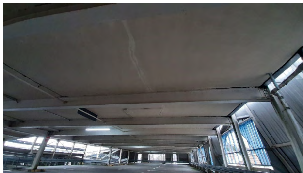
Abbildung 25: Risse mit deutlichen Feuchtespuren
