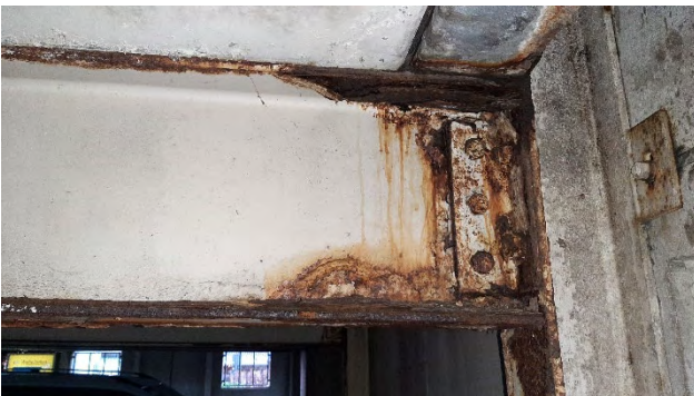
Abbildung 46: korrodiertes Stahlträger im Auflagerbereich
