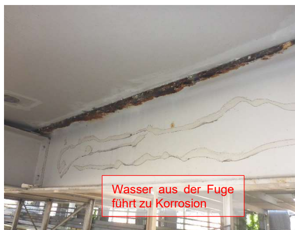
Abbildung 8 Stark korrodierter oberer Flansch des Stahlträgers mit abblättrender Beschichtung
