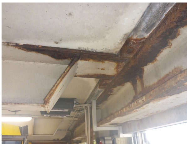
Abbildung 25 Flächige Korrosion über die gesamte Trägerlänge
