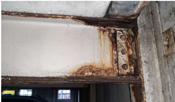
Abbildung 31 Anschluss stark korrodiert, übergreifende Korrosion auf die Stütze
