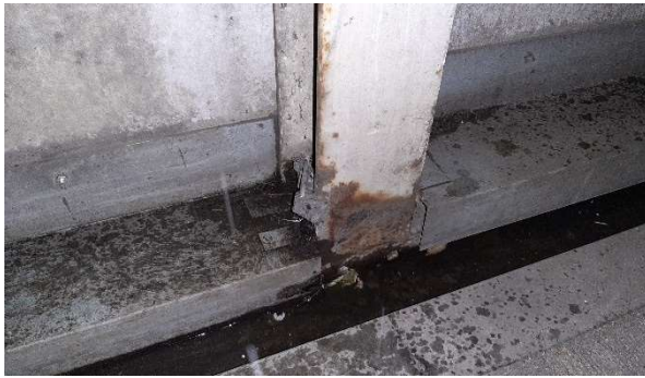
Abbildung 29 Korrosion am Stützenfuß
