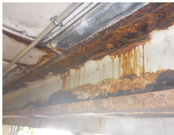
Abbildung 26 Flächige Korrosion über die gesamte Trägerlänge
