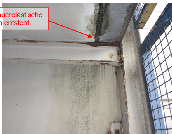
Abbildung 22 Korrodierter Randträger im Bereich des Auflagers
