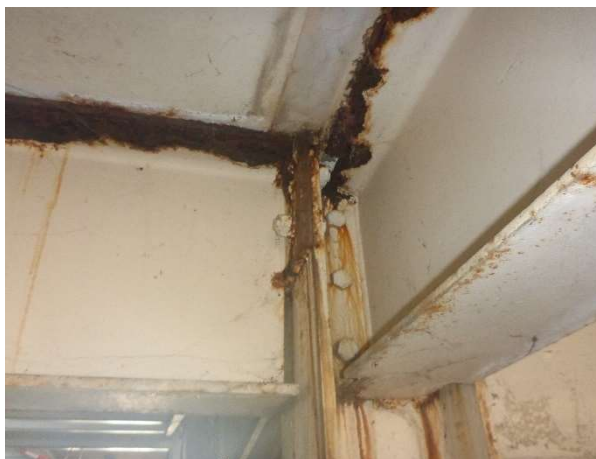
Abbildung 35 Starke Korrosion mit vermindertem Querschnitt des oberen Flansches, Stütze weist nur Rostfahnen auf
