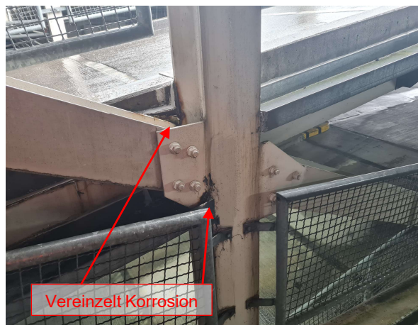
Abbildung 18 Rampenstütze mit Anschluss des Verbandes, leichte Korrosion
