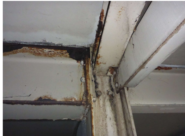
Abbildung 32 Anschluss mit wenig Korrosion, Stütze in gutem Zustand
