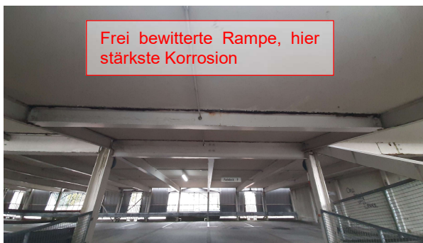
Abbildung 17 Rampe von Parkdeck 10 zu 11, stärkste Korrosion nur an diesen Rampen der Ebenen, da frei bewittert
