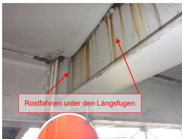
Abbildung 7 Im Bereich des Auflagers unter den Längsfugen, Rostfahnen
