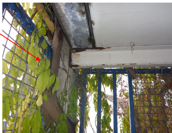
Abbildung 20 Korrodierter Randträger im Bereich des Auflagers mit Pflanzenbewuchs
