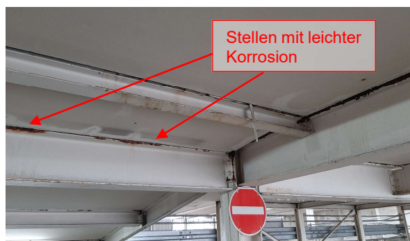
Abbildung 16 Vereinzelt leichte Korrosion
