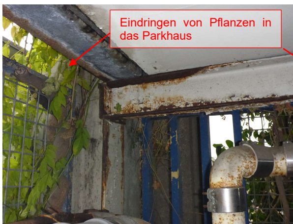
Abbildung 19 Korrodierter Randträger im Bereich des Auflagers mit Pflanzenbewuchs
