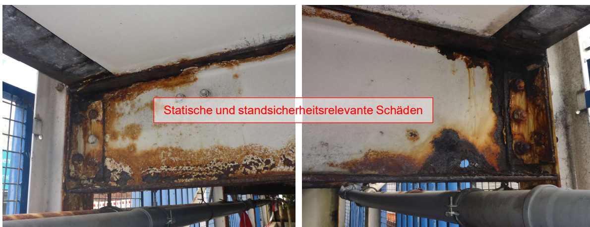
Abbildung 10 Korrosion des Anschlusses
